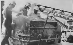
Special mixer to prepare refractory mortar to build wall. Un mezclador especial pa prepara mezcía pa baha muraya.
